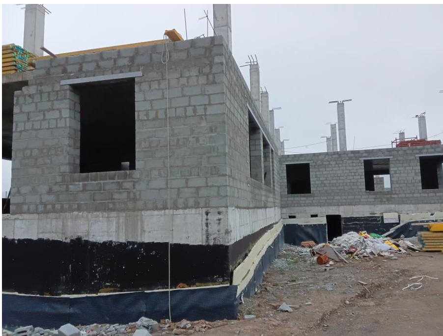
Объект незавершенного строительства: г. Владивосток, ул. Кипарисовая, д. 4 Фото Контрольно-счетной палаты Приморского края от 24.06.2026
