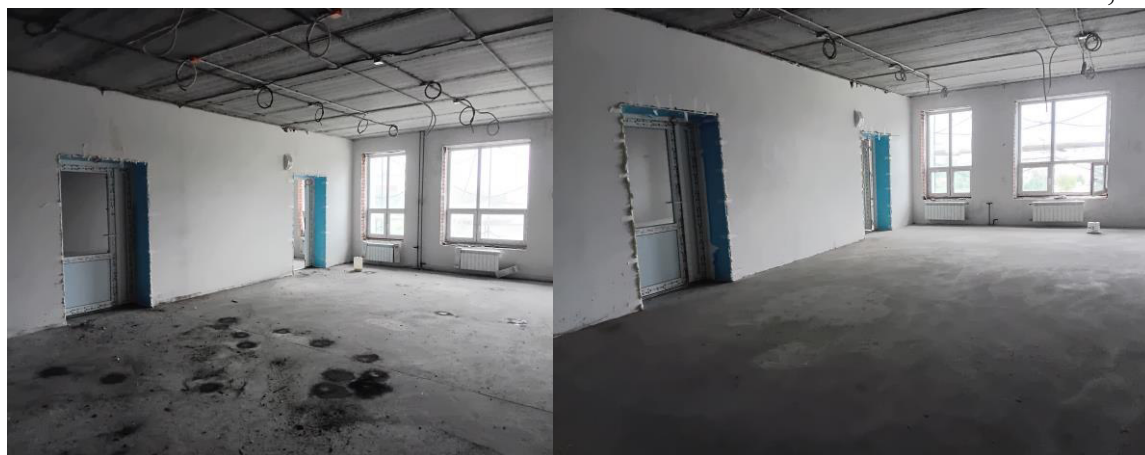
Спортивный и музыкальные залы здания, расположенного в г. Уссурийске по ул. Выгонная, 1а Фото Контрольно-счетной палаты Приморского края от 22.06.2026
