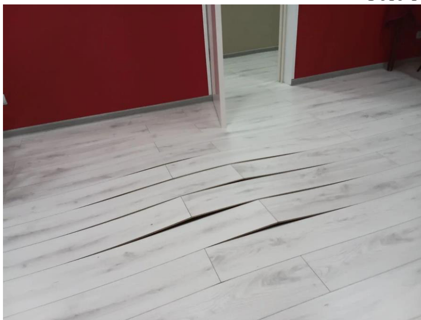
Дефекты полового покрытия в помещении многофункционального пространства в здании по адресу: г. Владивосток, ул. Полярная, 7 Фото Контрольно-счетной палаты Приморского края от 13.04.2026
