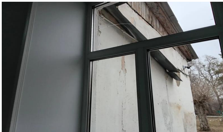
Коридор здания Дома молодежи (г. Спасск, ул. Дербенева, 3) Фото Контрольно-счетной палаты Приморского края от 15.04.2026
