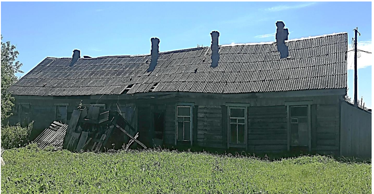
Аварийный многоквартирный жилой дом по ул. Суханова, 7 в пгт Приморский Фото сделано сотрудниками Контрольно-счетной палаты 15.08.2025
