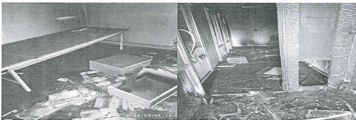
Помещения ФАП п. Таежный после пожара фото предоставлены сотрудниками Учреждения
