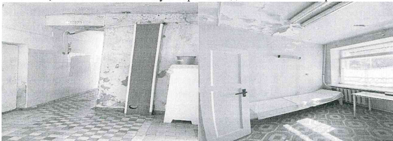
Помещения ВА п. Рудный; фото Контрольно-счетной палаты Приморского края от 25.07.2023
