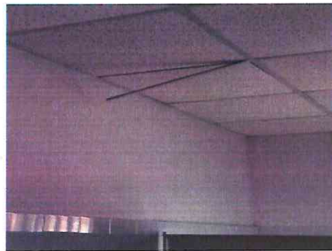
Дефект потолочной плитки
