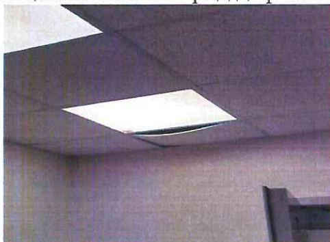
Дефект потолочной плитки
