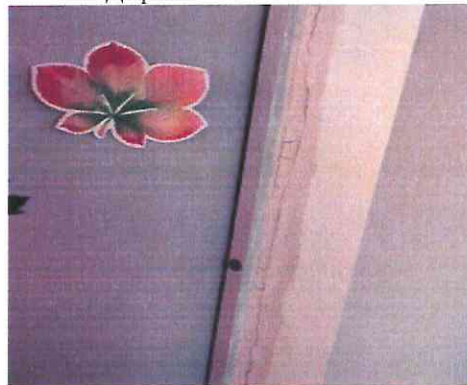
Дефект дверного проема
