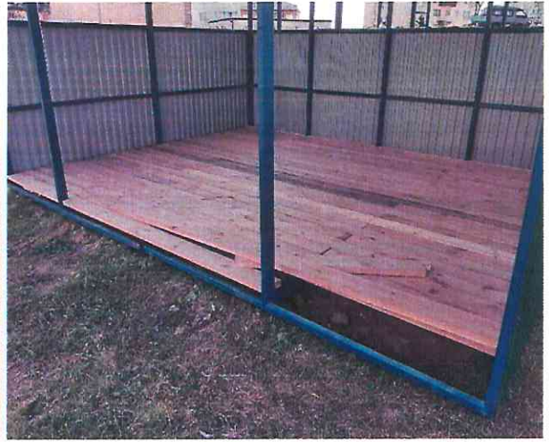
Дефекты полового покрытия в беседке
