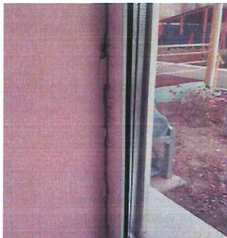
Дефект оконных откосов
