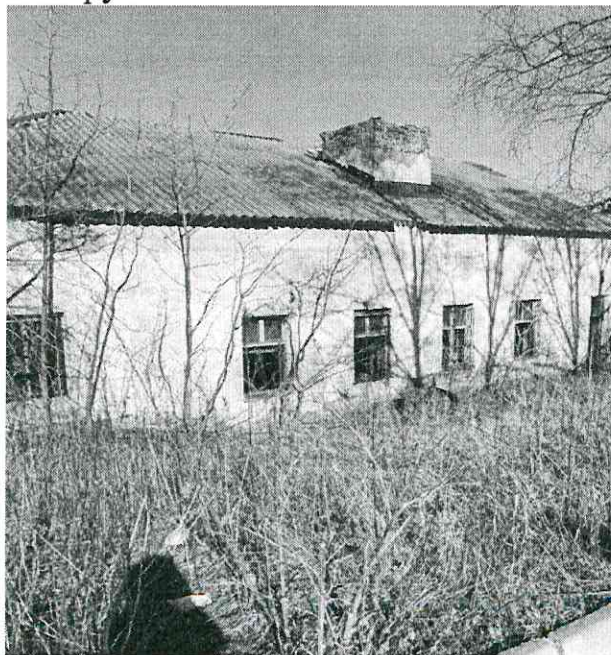
Котельная №1 Фото Контрольно-счетной палаты Приморского края 02.03.2022
