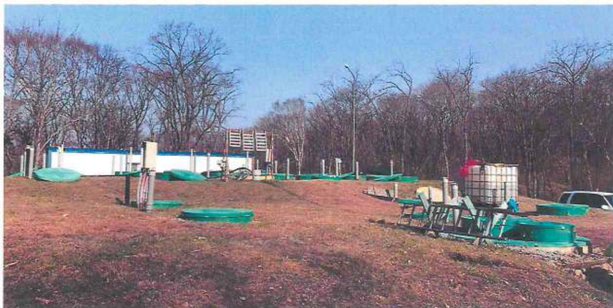
Локальные очистные сооружения
