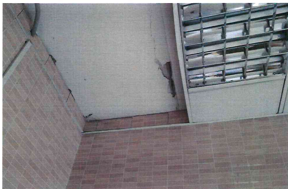
Потолок умывальной комнаты на 3 этаже в здании: г. Артем, ул. Фрунзе, 8 Фото Контрольно-счетной палаты Приморского края от 19.10.2021
