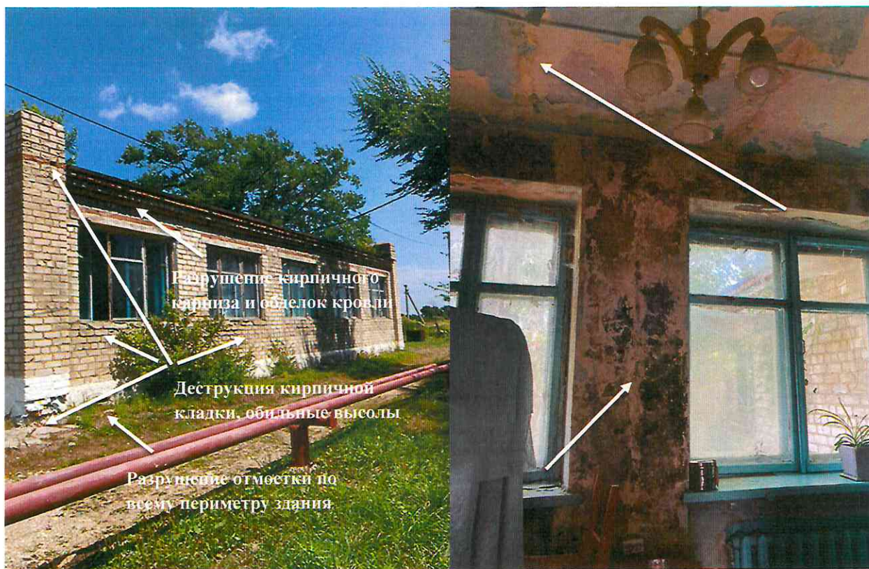
Общий вид фасада здания ФАП с. Первомайское, ул. Ленинская, д.28а, пом.1, 1979 года постройки. Численность прикрепленного населения с. Первомайское составляет 1 365 человек. Фото Контрольно-счетной палаты Приморского края от 16.08.2021
