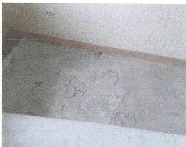
фото Контрольно-счетной палаты от 17.09.2020 (г. Лесозаводск, ул. Мира, 2В, кв. № 33)
