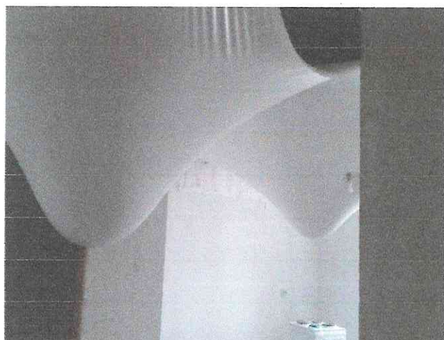
фото Контрольно-счетной палаты от 17.09.2020 (г. Лесозаводск, ул. Мира, 2Б, кв. № 2)
